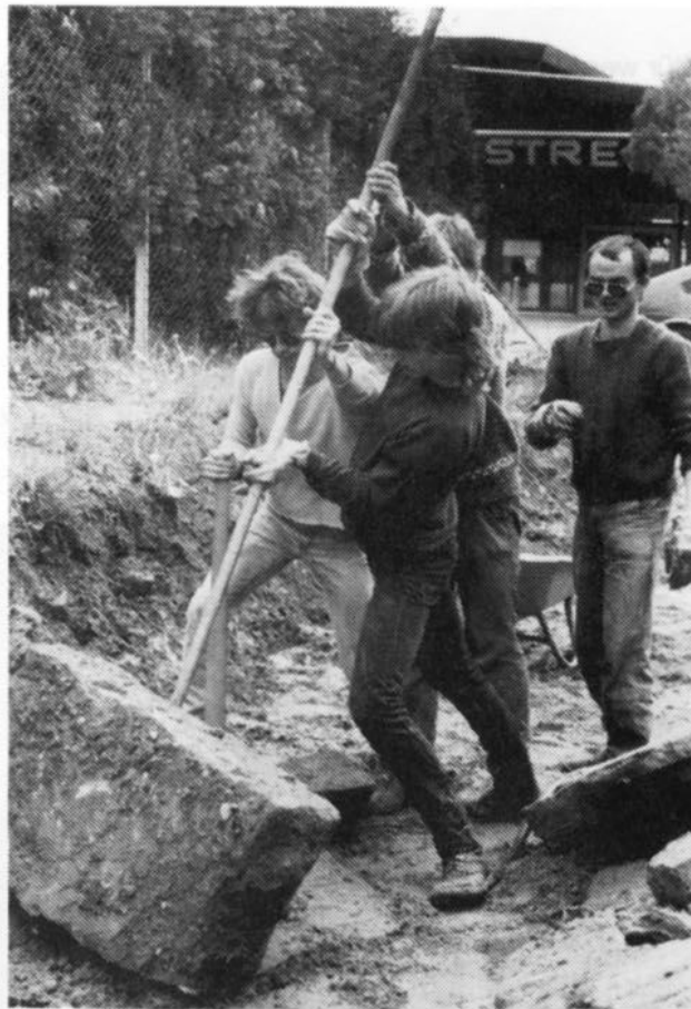
Jugendliche vom Jugendtreff beginnen im Außenbereich des Jugendhaus' mit dem Bau einer Sitzmauer.
